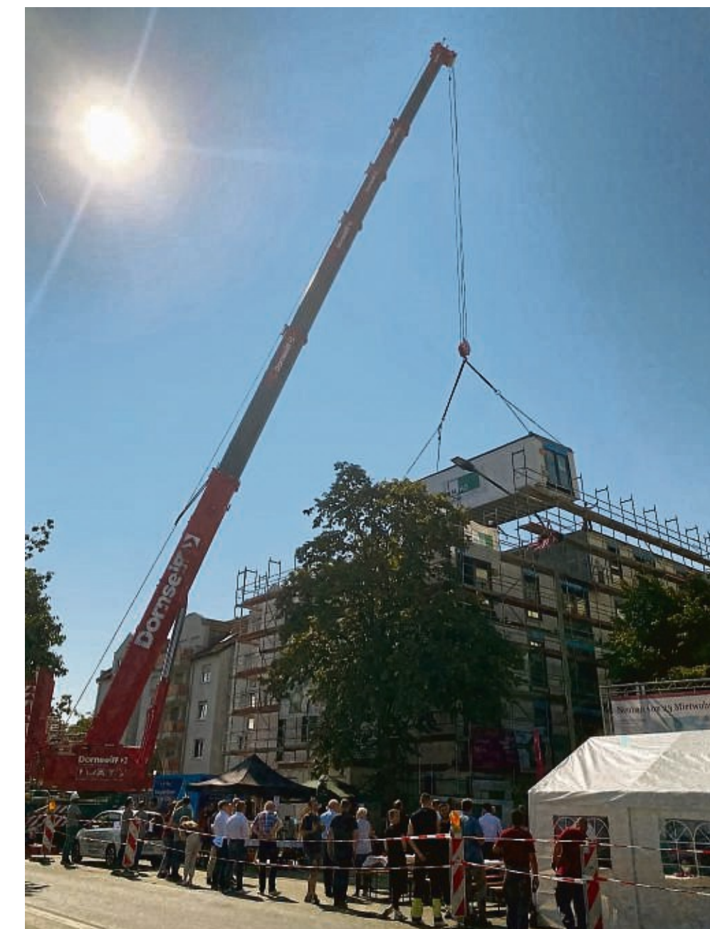
Der letzte Baustein: Vor dem Richtfest wird auf den Neubau der städtischen Wohnbau in der Lämmerspieler Straße 51a noch ein Modul aufgesetzt. FOTO: RON
